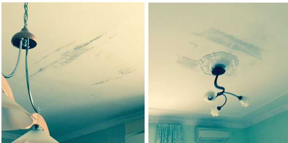
Vista delle macchie di umidità a soffitto: foto 23 e 24
