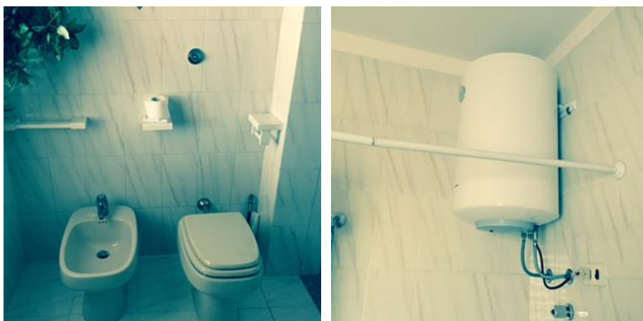
Bagno – vista degli igienici e del boiler: foto 21 e 22
